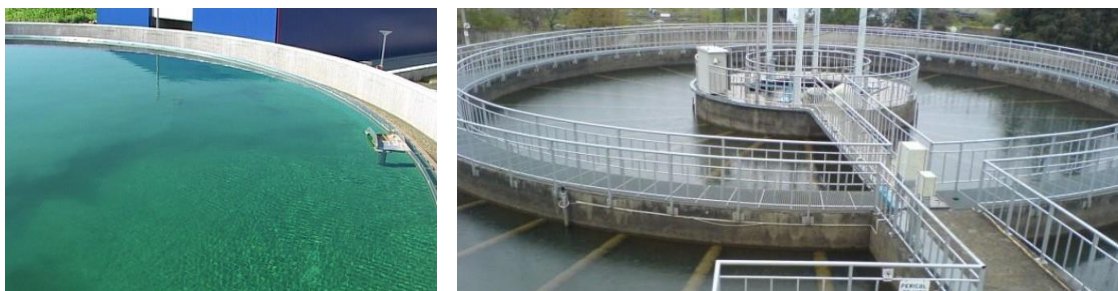
Figura 2.2. Stație nouă de tratare a apei Beclean (2013)
